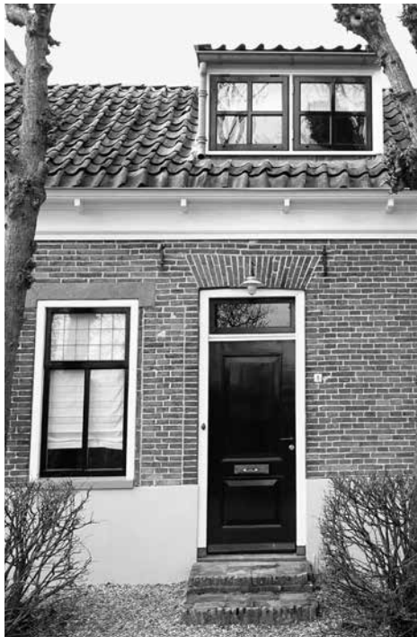
De scheiding in het metselwerk (foto Koos van de Belt)
