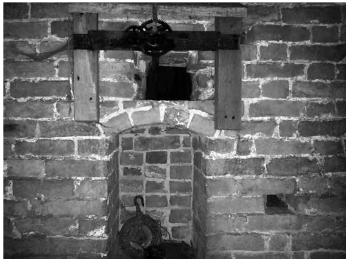
De binnenzijde van de toren ter plaatse van de wijzerplaat, daaronder de dichtgemetselde opening (foto Jan van Dijk)
