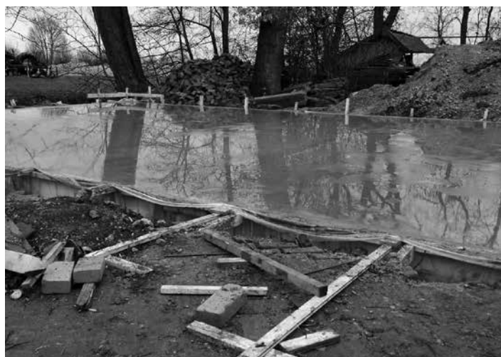
De betonnen vloer van de kapschuur is inmiddels gestort (foto Andries Hof)
