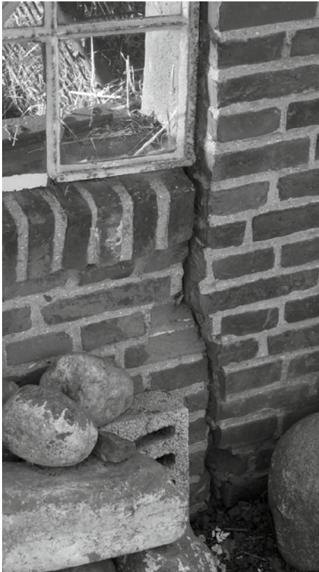
Voorbeeld van forse aardbevingsschade (foto: Andries Hof)
